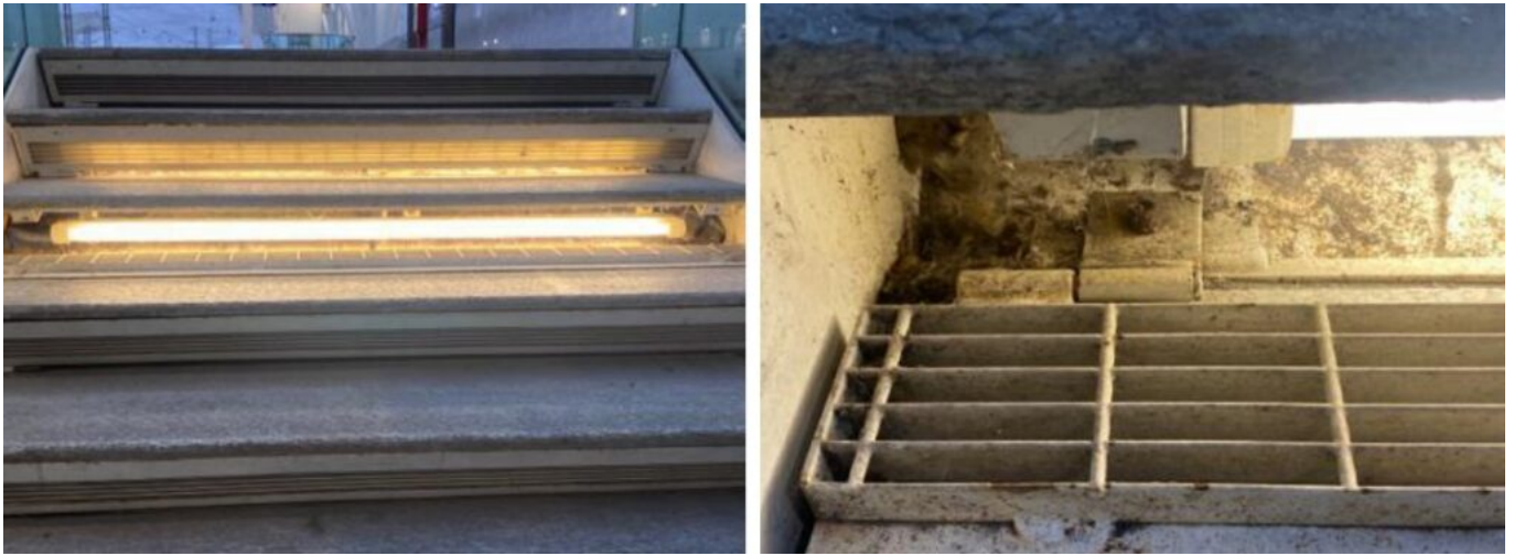
a) Gradini di una scalinata d'accesso ai binari. b) Dettaglio dell'alzata di un gradino con griglia aperta per la manutenzione (photo credits Augusto Giuffredi).
